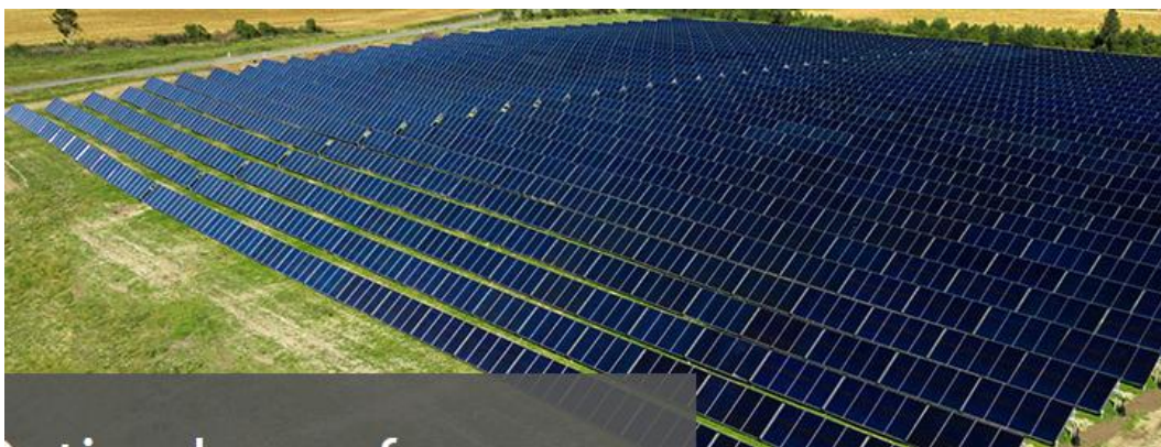
Figur 24 – Solfangeranlegg levert av Savo-Solar
