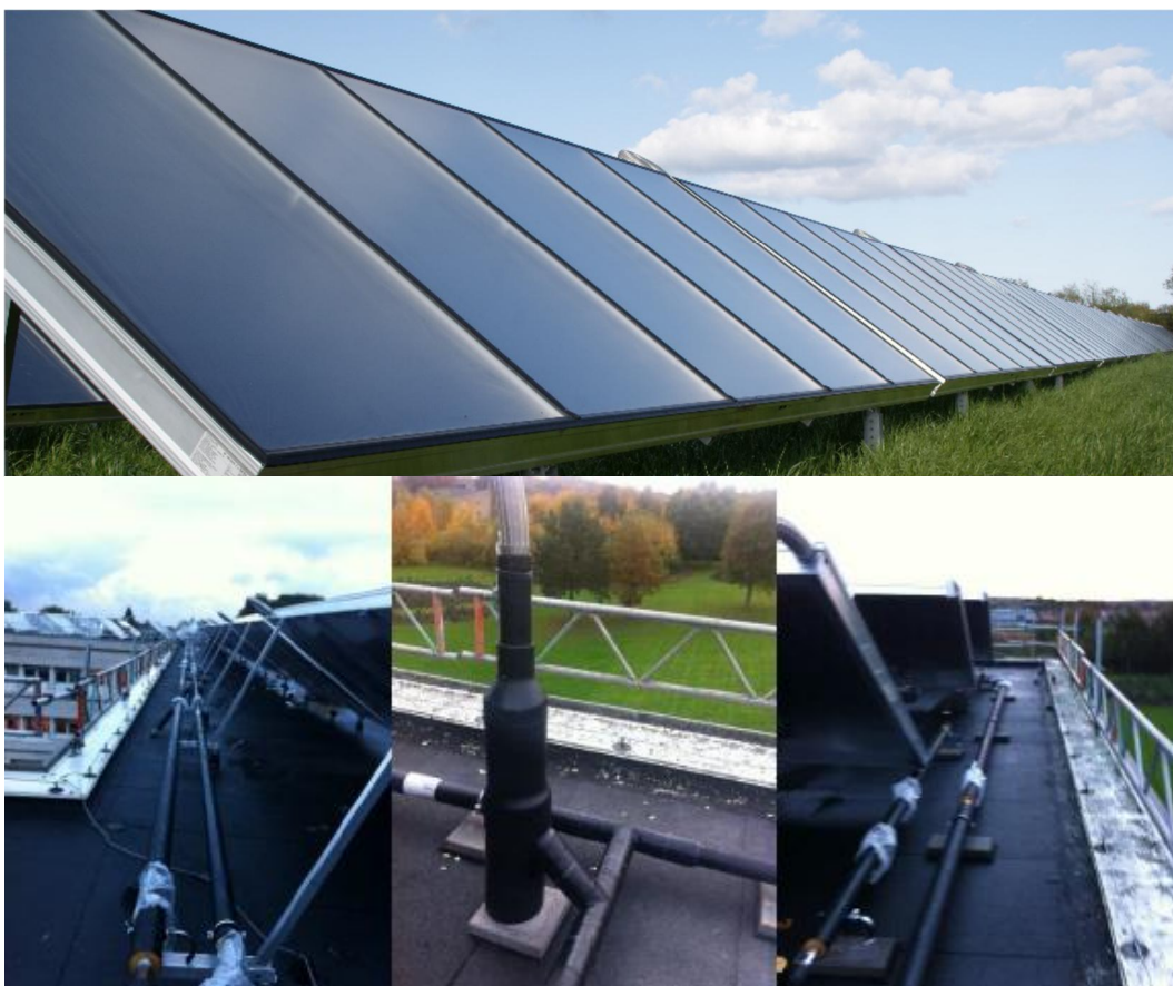
Figur 25 – Solfangeranlegg fra Arcon-Sunmark.
