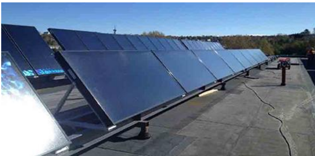
Figur 3 – Solfangeranlegg på Scandic Hotell Lerkendal i Trondheim. Solfangere produserer varme, ved at solinnstråling varmer opp et medium som pumpes gjennom rør i solfangerne. Varmen avgis til en varmesentral.
